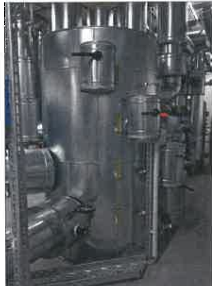
Heizungs- und Kälteverteilungen in Industriegebäuden erfordern eine Anlagenhydraulik, die sowohl eine gleichmäßige Verteilung der Wassermengen als auch schnelle Lastwechsel problemlos bewältigt. (Bilder: Zortea Gebäudetechnik GmbH)
