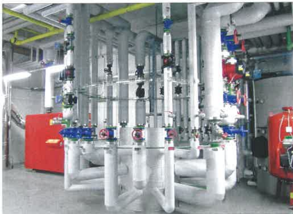
Die stufenweise Temperaturschichtung der Zortström-Technologie versorgt alle angeschlossenen Kreise mit ihren jeweiligen Systemtemperaturen und Massenströmen. Bei entsprechender Vorplanung ergibt sich eine einfache Leitungsführung.
