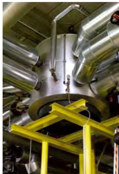
ZORTSTRÖM über den Kesseln
