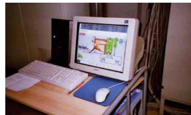
Überwachsungs-, Leistungs- und Verbrauchskontrolle mit Leittechnik
