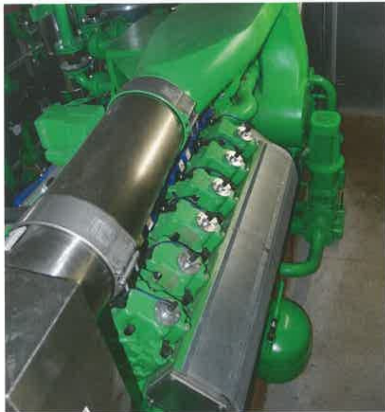
Auch die Laufzeit der beiden BHKW wurde optimiert. Aufgrund der Anpassungen konnten 2014 50 Prozent des gesamten Gebäude-Strombedarfs aus diesen Modulen gedeckt und der so produzierte Strom nahezu vollständig selbst verbraucht werden. Bild: Deutsche Börse AG
