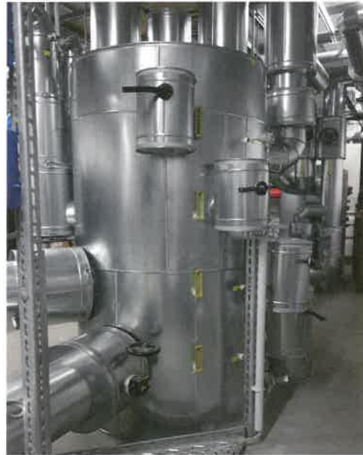
Heizungs- und Kälteverteilungen in Industriegebäuden erfordern eine Anlagenhydraulik, die sowohl eine gleichmäßige Verteilung der Wassermengen als auch schnelle Lastwechsel problemlos bewältigt.
