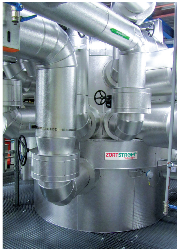
Dreistufiger Zortström Multi-K. Die rund 2,8 m hohe Anlage verfügt über einen Durchmesser von 2.100 mm und einen Inhalt von etwa 8,5 m 3 .
