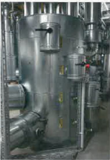
Die Heizungs- und Kälteverteilungen in Industriegebäuden, wie hier beispielsweise bei VW, erfordern eine Anlagenhydraulik, die sowohl eine gleichmäßige Verteilung der Wassermengen als auch schnelle Lastwechsel bewältigt. Bilder: Zortea
