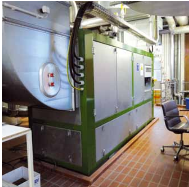
BHKW-Leistung ca. 207 kW
