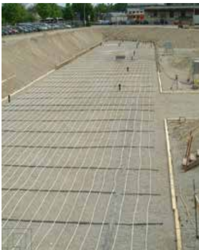
Kollektoren unter den Fundamentplatten für die Entnahme und Regenerierung von Wärme
