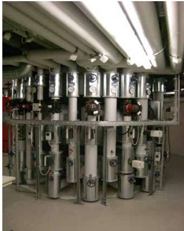
ZORTSTRÖM ® Sammel und Verteilzentrum für die Heizung
