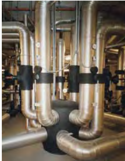
Landeskrankenhaus Bregenz ZÖRTSTRÖM Kühlung
