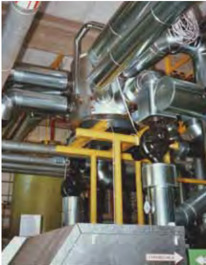
Nahwärme Altdorf bei Nürnberg ZÖRTSTRÖM über den Kesseln
