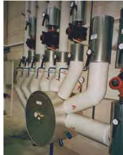
Rädisch GmbH Lasertechnik, Kirchheim-Teck ZÖRTSTRÖM-Vorwananlage
