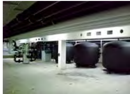
Puffer Beladen und Entladen von Wärme und Kälte je nach Anforderung.
